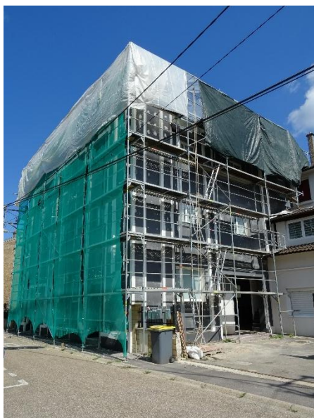
Isolation thermique et ravalement de façade, rue de la Liberté à Knutange
