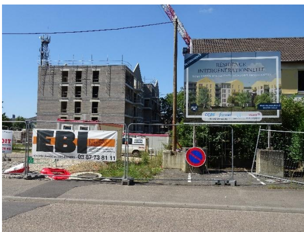
Résidence intergénérationnelle, rue de l'Argonne à Florange
